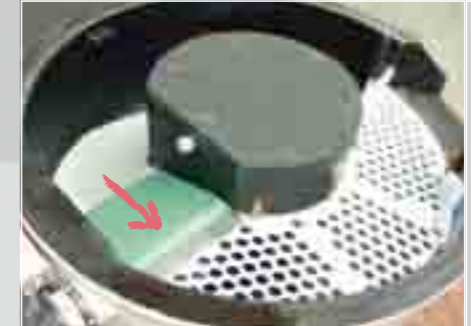
Trappe de séparation fermée
